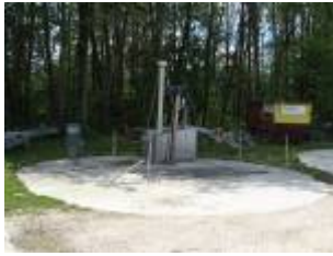
Abbildung 3.1.11 Vorgrube - Unterflur mit Betondeckel, Foto: DBFZ
