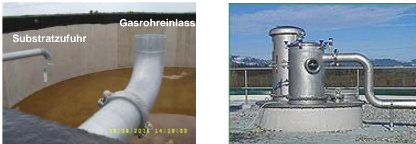
Abbildung 3.3.1 Vorrichtungen zur störungsarmen Gasabfuhr; Links: Gasrohreinlass mit Öffnung nach oben (links die Substratzufuhr); Rechts: Gasdom mit hydraulischer Über-, Unterdrucksicherung sowie Schaumfalle und Gasabgang
