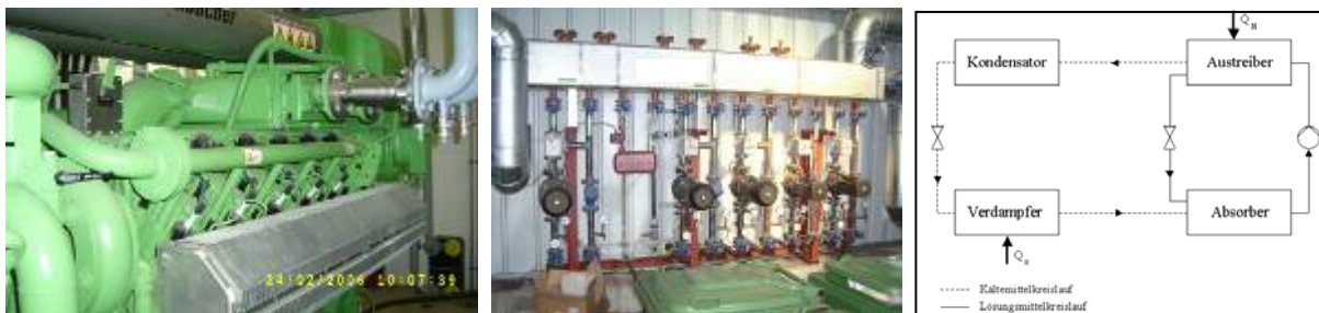
Abbildung 3.3.8 Beispiele zur gekoppelten Kraft-Wärme-Erzeugung; Links: BHKW bei der Montage; Mitte: Wärmeauskopplung an Wärmeverteilstation; Rechts: Prinzip der Kälteerzeugung aus Wärme; Fotos: DBFZ
