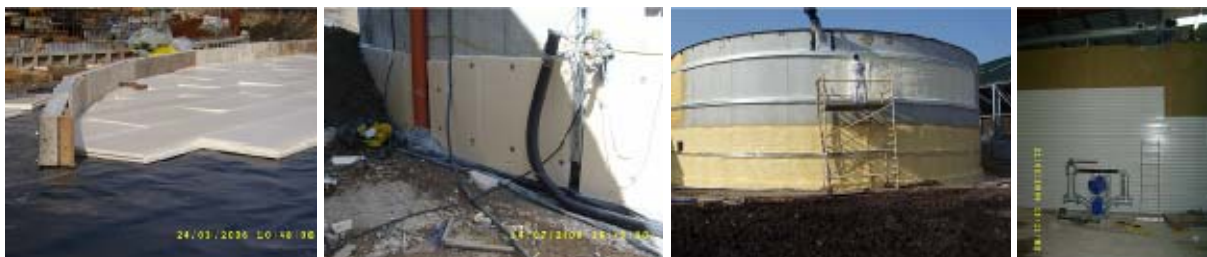
Abbildung 3.2.14 Beispiele für Behälterisolierungen; von links: Bodenisolierung, Wandverkleidung im Bodenbereich, Sprühschaum, Trapezblechverkleidung quer an Boxenfermenter; Fotos: alle DBFZ, außer 3.v.l.: Pluimers Isolatie bv.
