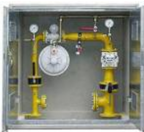
Abbildung 3.3.10 Übergabe von aufbereitetem Biogas zur weiteren Nutzung mit einer Gaseinspeisestation
